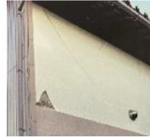
被災した外壁
