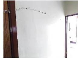
被災した内壁
