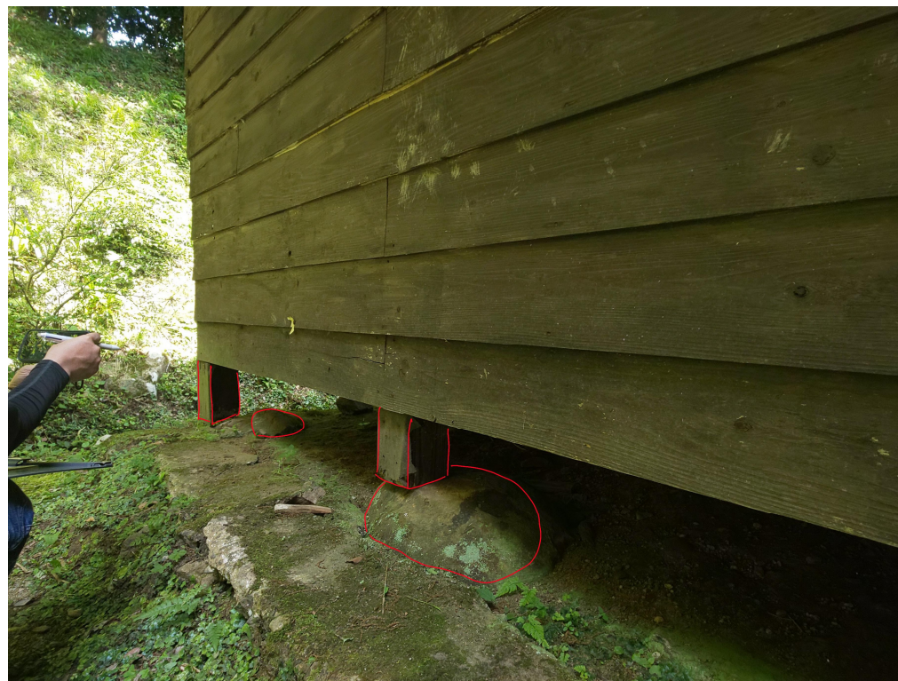
礎石からずれた柱
