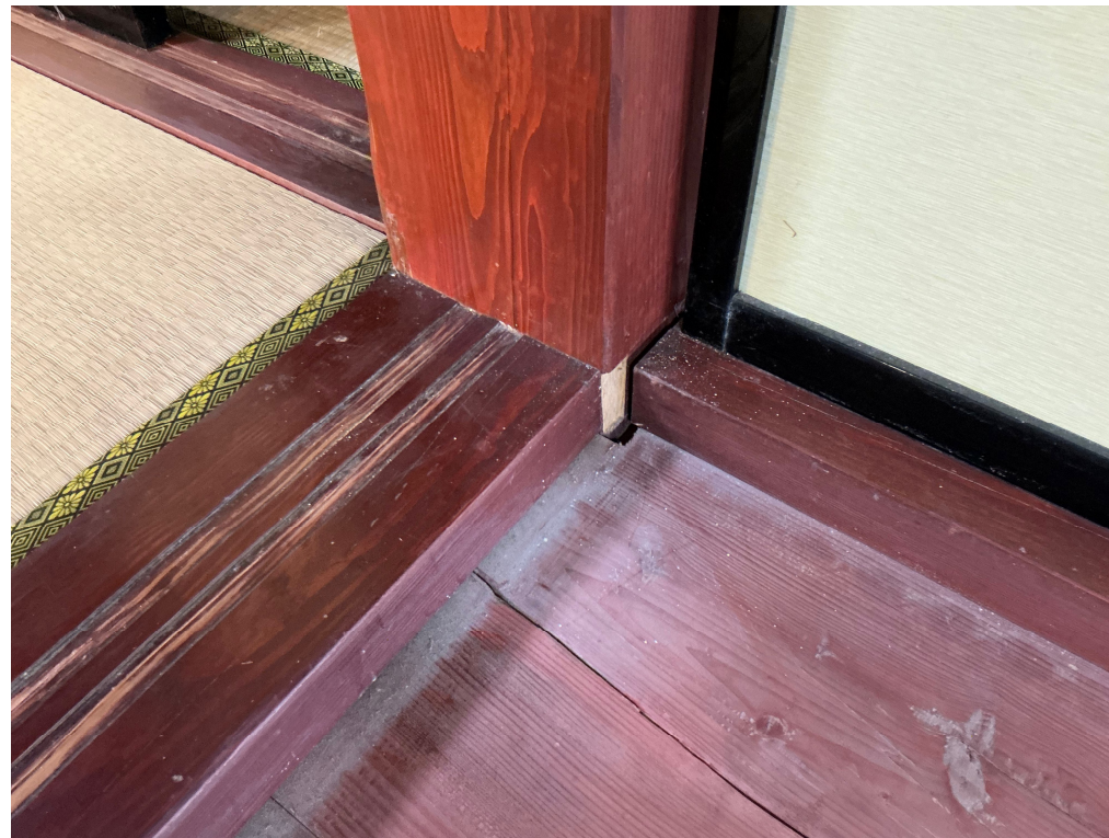
敷居のずれがある
