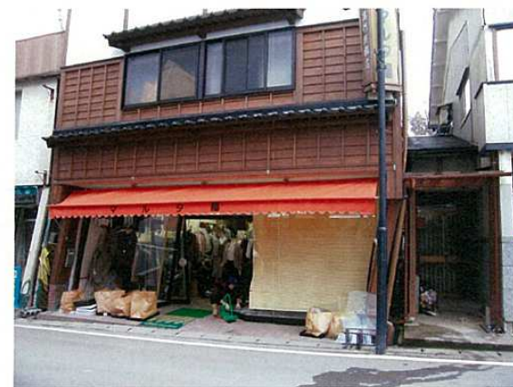
修復前（全壊判定）
